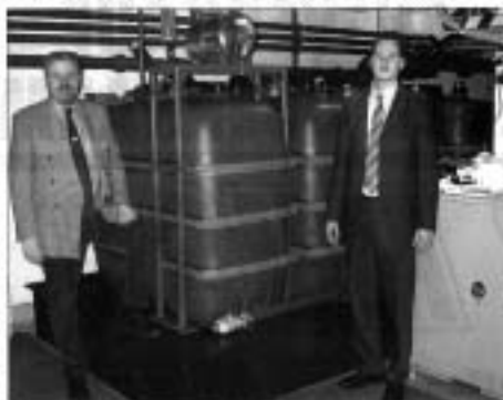
Die Regenwasseranlage zur Spülung der Anlagen, die Produktentwickler Frank Schulte und Marco Lohmann vor der Inbetriebnahme zeigen, wurde schon vor sehr langem gebaut. Foto: Wierski
